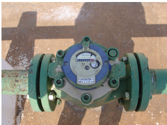
Figura 2 - Medidor de vazão do poço CGR – 194
