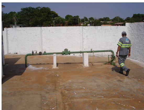
Figura 1 - Instalações do Poço CGR - 065
