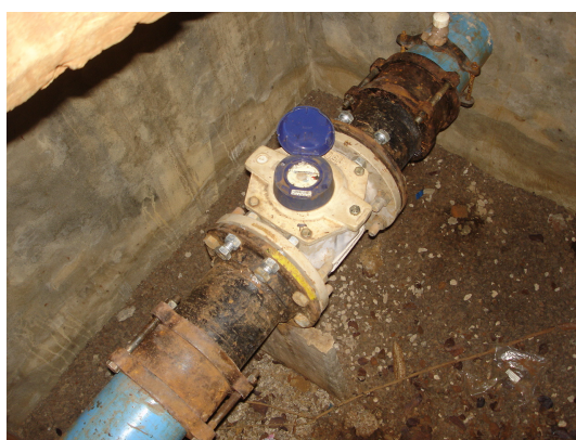
Figura 3 - Macromedidor de Vazão da ligação de reforço da Avenida das Roseiras
